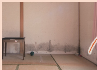
結露によりカビが発生。
