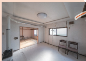
結露により壁全体が傷んでいます。
